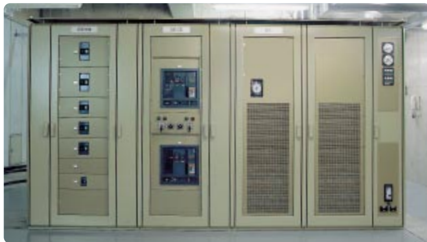
所内キュービクル 関西電力(株)殿 上二変電所
