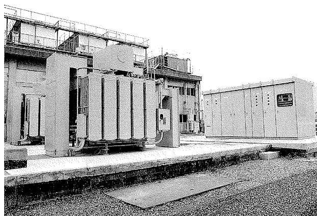
図2 24 kV 列盤型 GIS と主変圧器
