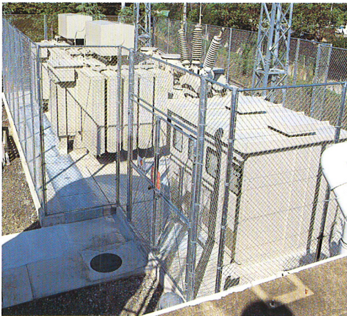
77kV 受変電設備 (本文22ページ)
