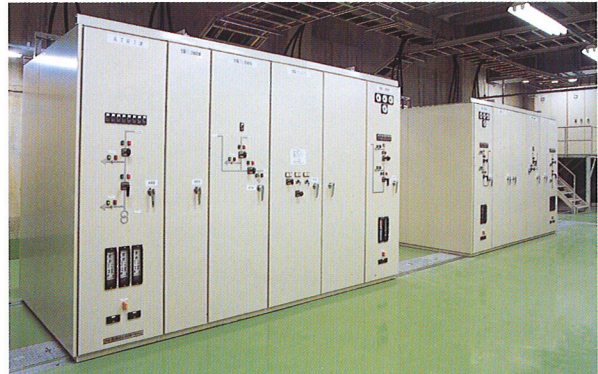
22kV 列盤形GIS (本文27ページ)
