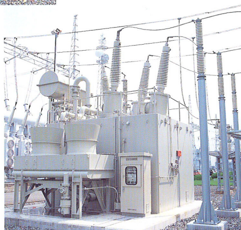
154kV 60MVA分路リアクトル (本文9ページ)
