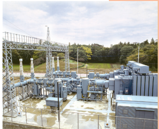
3φ 50Hz 147/6.6kV 10,000kVA
