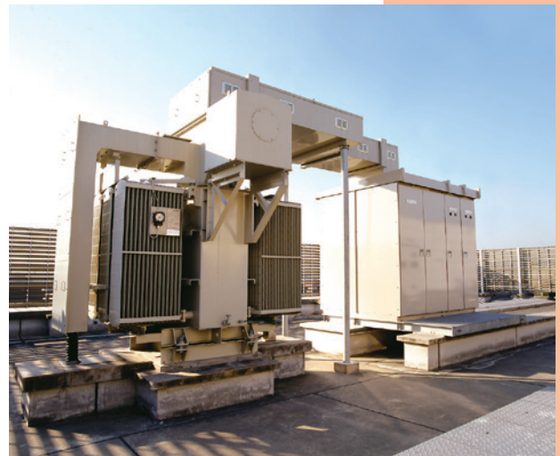
3φ 60Hz 21/6.6kV 5,000kVA
