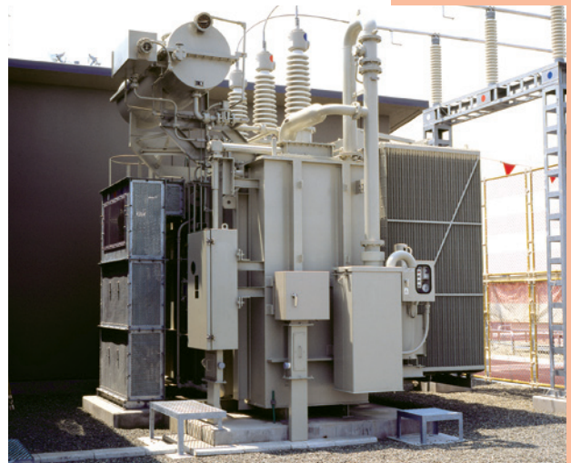
3φ 60Hz 66/6.9kV 20,000kVA
