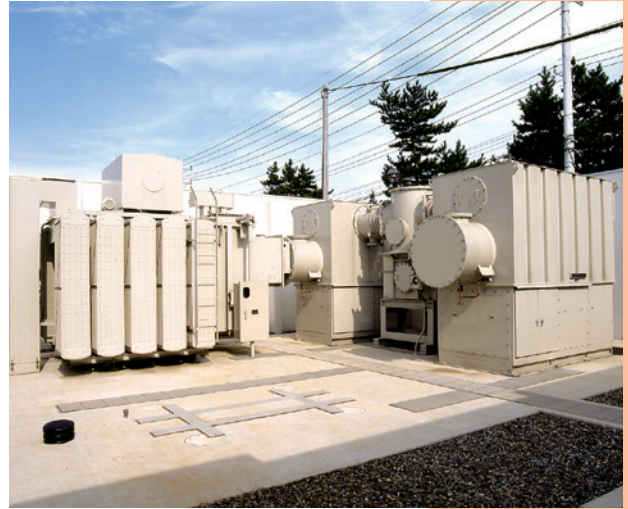
3φ 50Hz 66/6.6kV 7,500kVA
