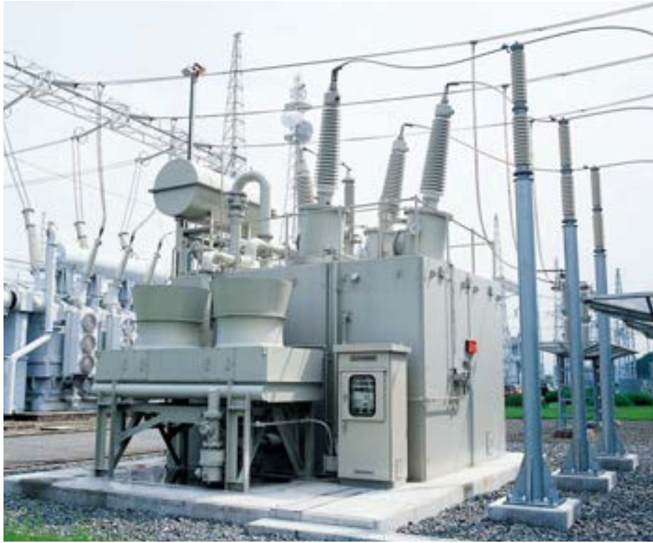
3φ 60Hz 154kV 60,000kVA(50トン)
