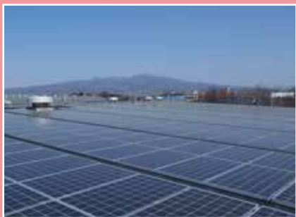
太陽電池(屋根設置)
