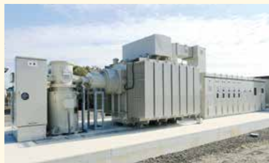
77kV特高連系設備
