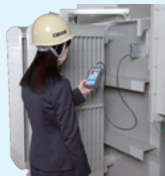
外壁から検出できます
