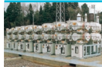
154kV ガス絶縁 開閉装置
