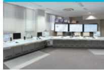
高速自動車道監視制御システム
