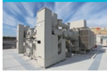
77kV特高受変電設備
