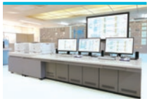
水処理集中監視制御システム
