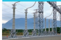
550kV コンデンサ形 計器用変圧器
