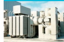
66/77kV 油入変圧器
