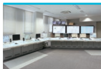
高速自動車道 監視制御システム
