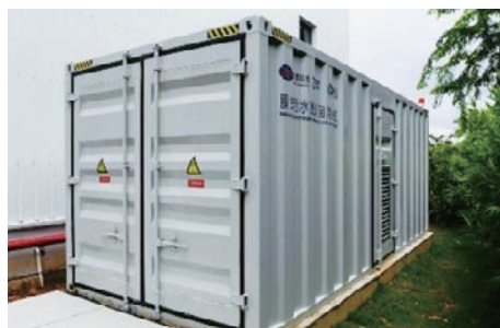
膜水処理設備
