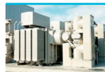
66/77kV 油入変圧器
