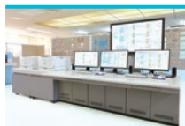
水処理集中監視 制御システム
