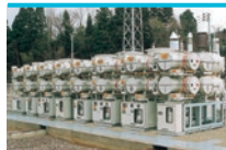
154kV ガス絶縁 開閉装置
