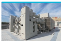
77kV特高受変電設備
