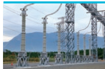
550kV コンデンサ形 計器用変圧器
