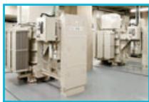
22/33kV スポット ネットワーク受変電設備
