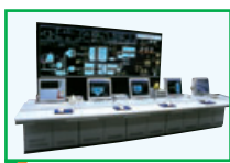
水処理集中監視 制御システム
