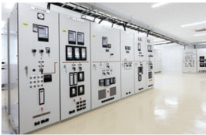
① 受変電実習室
