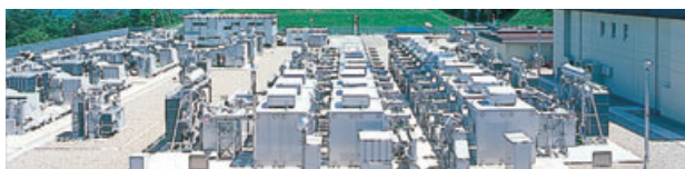
66/77kV 高調波フィルタ設備
