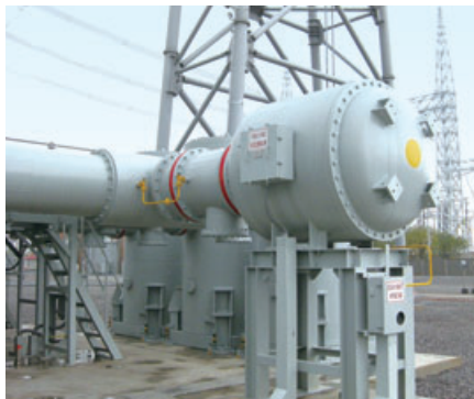
1,000kVガス絶縁計器用変圧器 (UHV VT)
