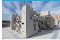
77kV特高受変電設備
