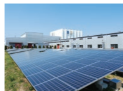
太陽光発電(自家消費)システム
