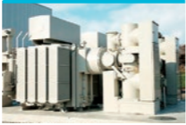
66/77kV 油入変圧器
