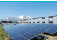
太陽光発電 (自家消費) システム
